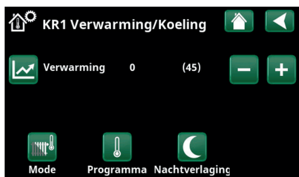
Menu "Installateur/Definieer/Verwarmingskring/Verwarmingskring 1". De verwarmingskring heeft geen ruimtevoeler, het setpoint staat tussen haakjes (vertrektemperatuur 45°C). Links van het setpoint staat de buitentemperatuur (0°C) bij de huidige vertrektemperatuur.
